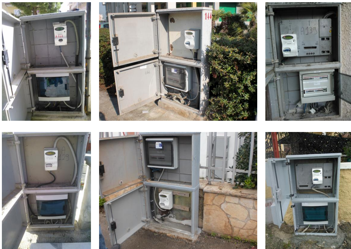
Classica conformazione quadri pubblica illuminazione
