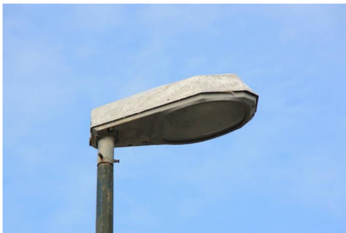
Armature stradali prive di vetro di chiusura
