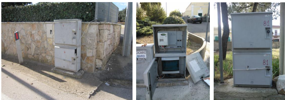
Armadi che necessitano di interventi manutentivi
